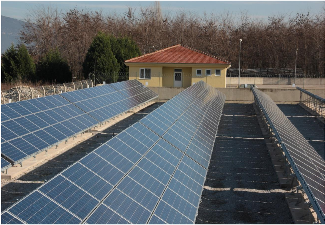
Şekil 3.5: 96 kilovatlık ongrid fotovoltaik güneş enerjisi santrali (Gürsu Belediyesi, erişim tarihi: 05.05.2015).
